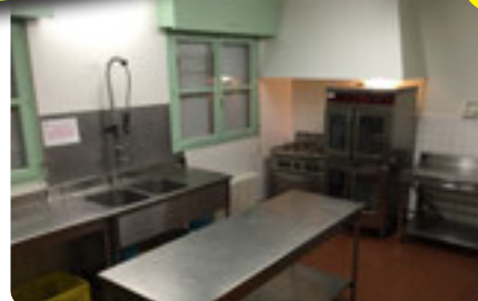
Plafond de la cuisine de la salle des fêtes en conformité suite à la commission sécurité. - Extracteur d'air à la salle des fêtes.
